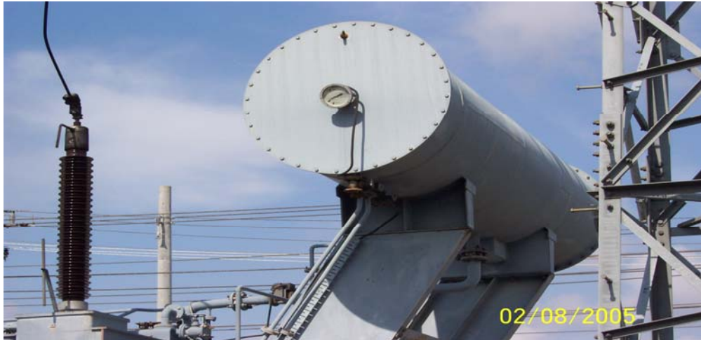
Gambar 3. 10. konservator minyak trafo
