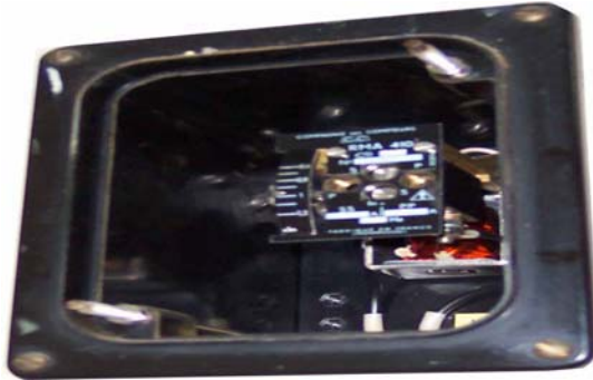
Gambar 3.34 : relai hubung tanah pada trafo
